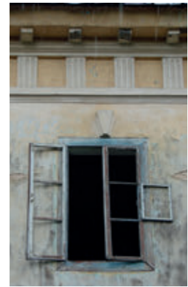
Рис. 9. Загальний вигляд стану вікна та його деталей другого поверху. 2020. Фото Т.Байцара
