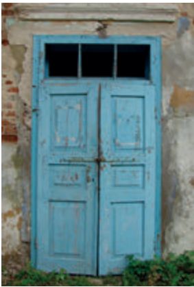
Рис. 7. Загальний вигляд стану вхідного порталу
