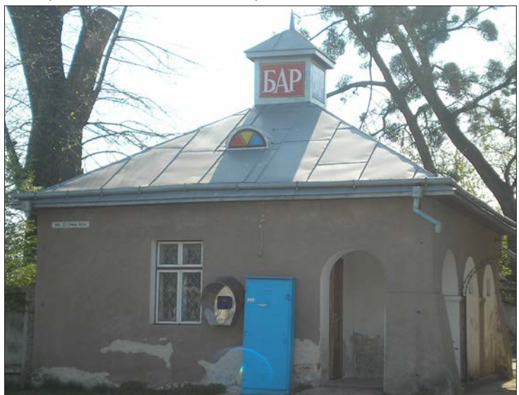
05. Будівля з арковим підсінням на вул. 22 Січня, 25 квітня 2009 р.
